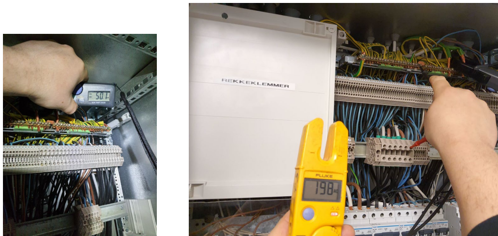
Figur 14 – t.v 50mA over jordleder fra Trafo via UPS, t.h. Overspenning fase L3 og Jord på UPS-kurs [5].
