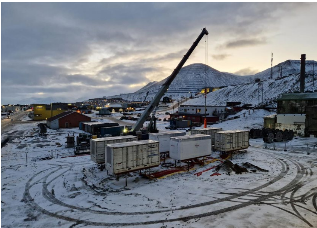
Figur 41 - Eksempel på batteribank park for kraftverket i Longyearbyen, etablert høsten 2022 Foto: Henriette Johansen
