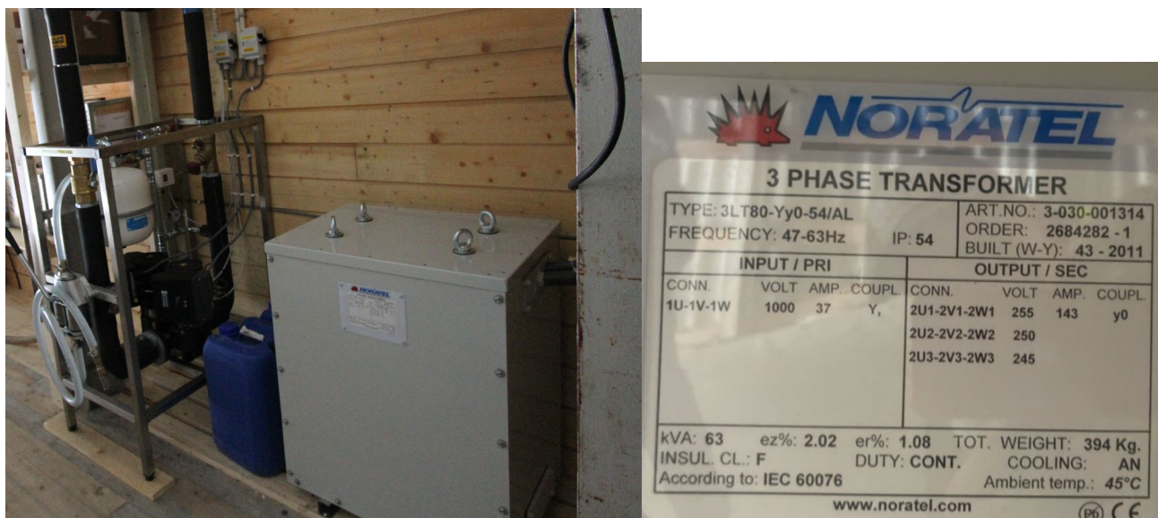
Figur 5 - Trafo ute i heistunnel oppe på Zeppelinobservatoriet - Fra 1000V til 250V [8].
