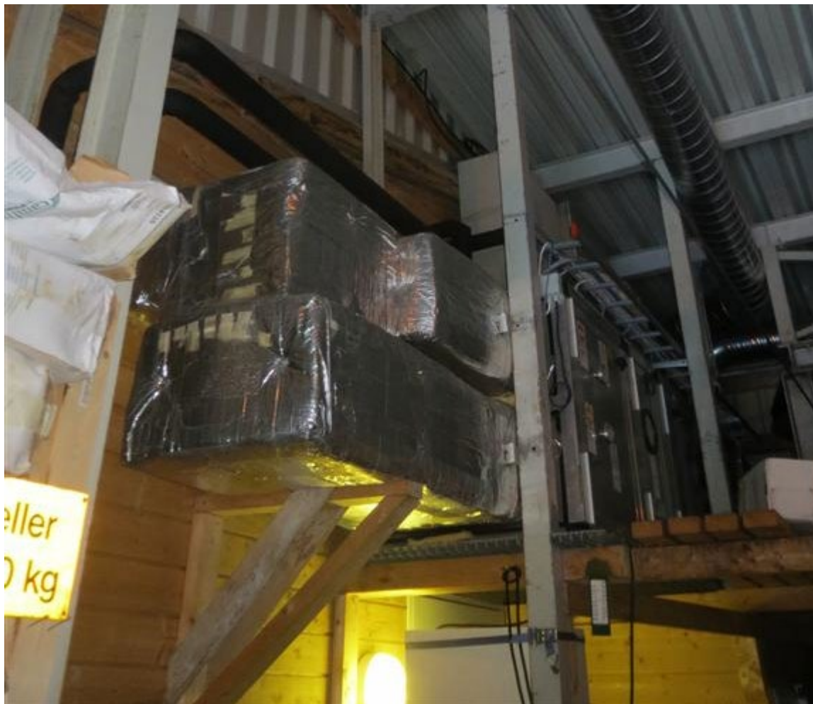
Figur 22 - Ventilasjonsaggregat over inngangsparti (i heishus)
