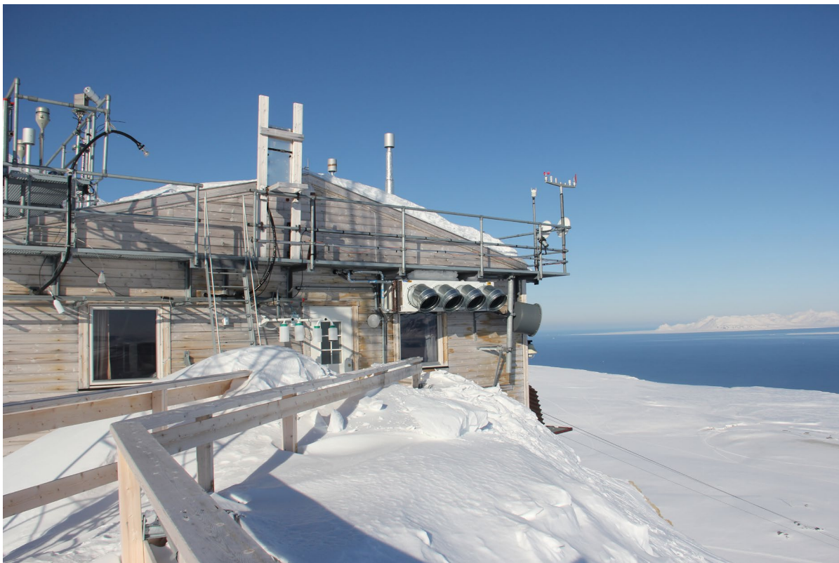
Figur 27 - Tidligere plassering av frikjølere på byggets østside.
