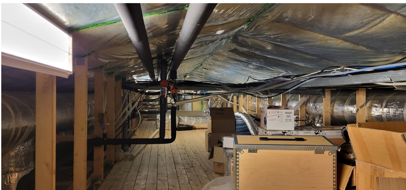
Figur 96 - Loft med fordeling av kjølevann, ventilasjon og strøm/teletraseer.
