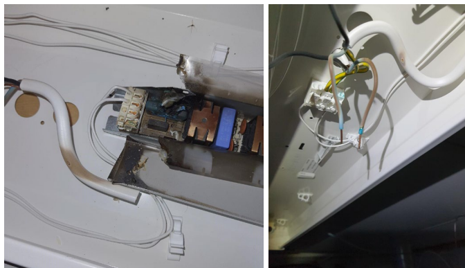
Figur 13 - Eksempel på skade på armaturer [5]
