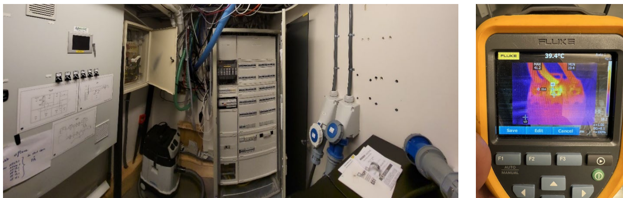
Figur 10 - Inntaksskap (t.v) og hovedtavle, samt termografering av ledninger i inntaksskapet.
