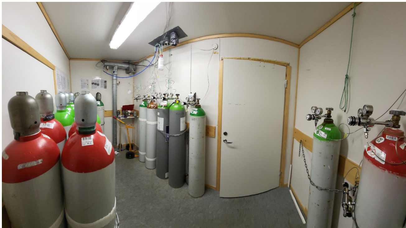
Figur 84 - Bilde av rom for oppbevaring av gassbeholdere.
