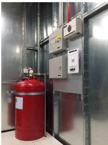
Figur 45 - Eksempel på gasstank og tilhørende styringspanel [15].
