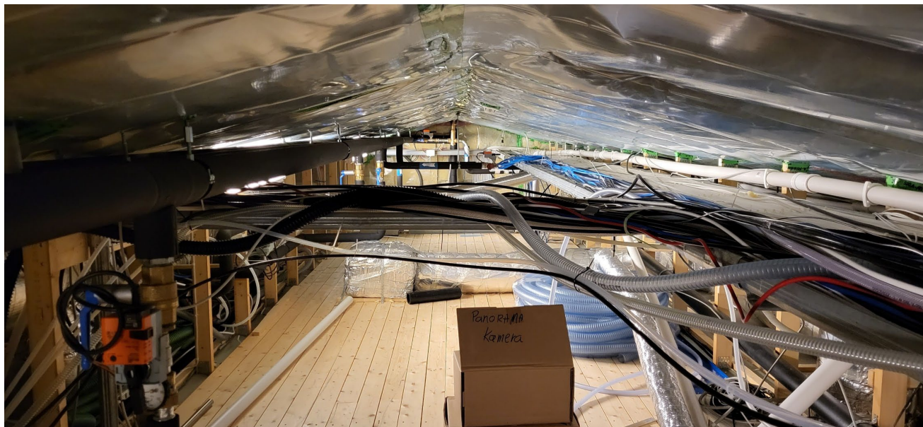
Figur 97 - Loft med fordeling av kjølevann, ventilasjon og strøm/teletraseer.
