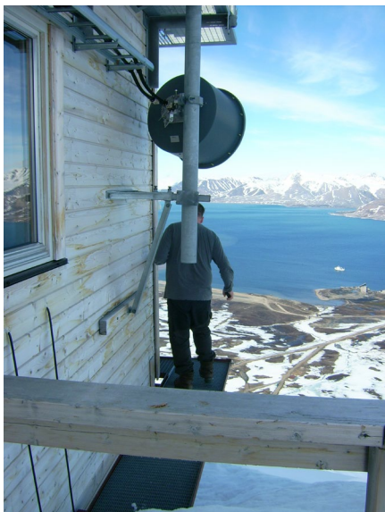
Figur 37 - Tidligere gangbru på Zeppelin. Ble ødelagt grunnet underdimensjonering av mengde snø.
